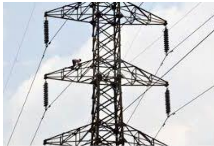
Gambar 3.19 kabela ACSR pada SUTT
