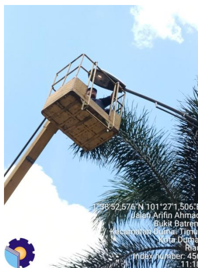
Gambar 2.57 Mengganti lampu SON-T
