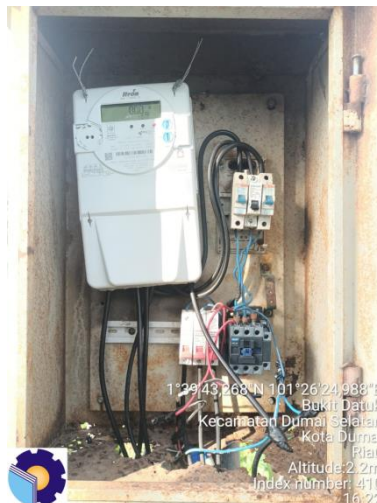
Gambar 2.41 Mengganti MCB dengan Photocell
