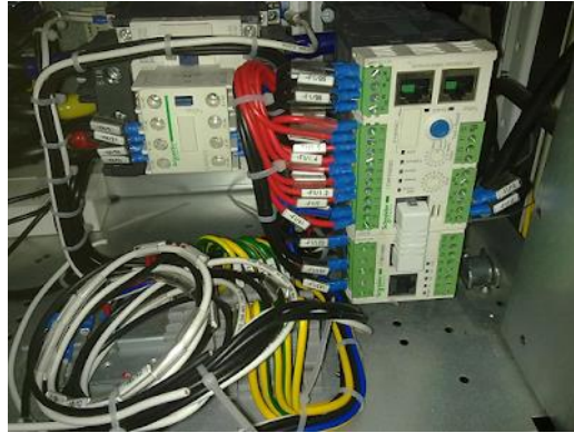
Gambar 3.10 Kabel NYAF yang terpasang pada panel
