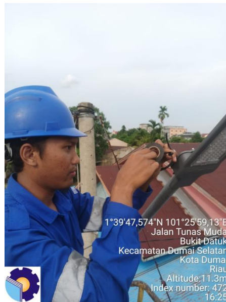
Gambar 2.58 Mengganti lampu SON-T
