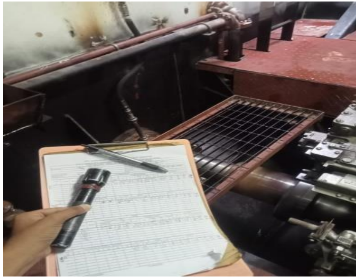
Gambar 2.46 Pengecekan Suhu di ruang mesin
