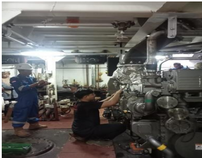
Gambar 2.45 Pengecekan Ruang Mesin
