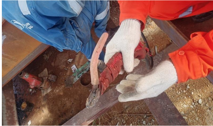
Gambar 2.18. stang las yang rusak.
