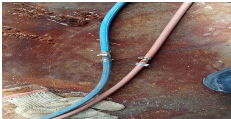
Gambar 2.15. Clamp omega pada kabel pada selang gas
