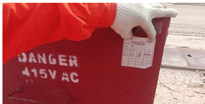
Gambar 2.16. Teks inspeksi pada panel listrik
