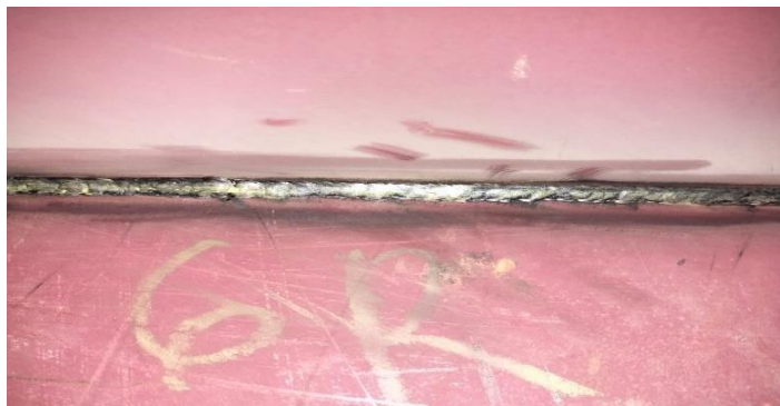
Gambar 3.3 Contoh gambar cacat las yang sudah di Repair
