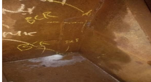
Gambar 2.40 Pengecekan Kebocoran Tangki Kapal Tongkang Pada Tangki 7,6,5,4
