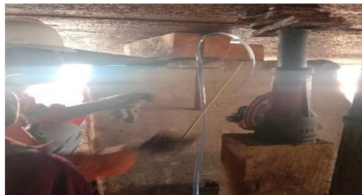
Gambar 2.112 kemiringan pada dudukan batu tahu dengan air dan selang
