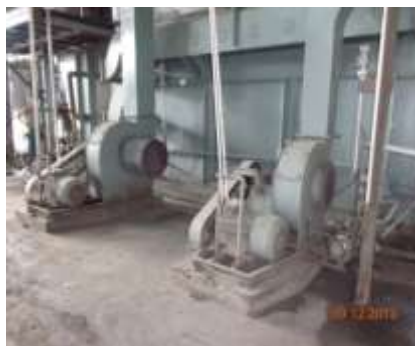
Gambar 3.136. Secondary air fan & Fuel feeder fan
