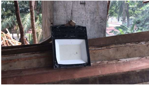
Gambar 3. 117 Lampu Penerangan (Sumber): Dokumentasi Lapangan 2023
