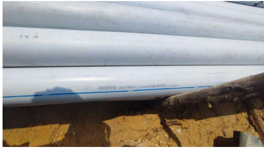
Gambar 3. 101 Pipa Pvc Aw (Sumber): Dokumentasi Lapangan 2023
