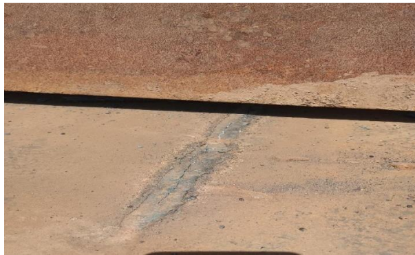
Gambar 2. 50 cacat pengelasan crack
