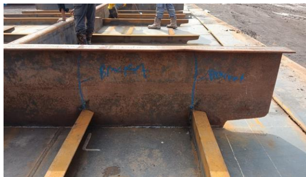
Gambar 2. 56 Tripping bracket yang kurang
