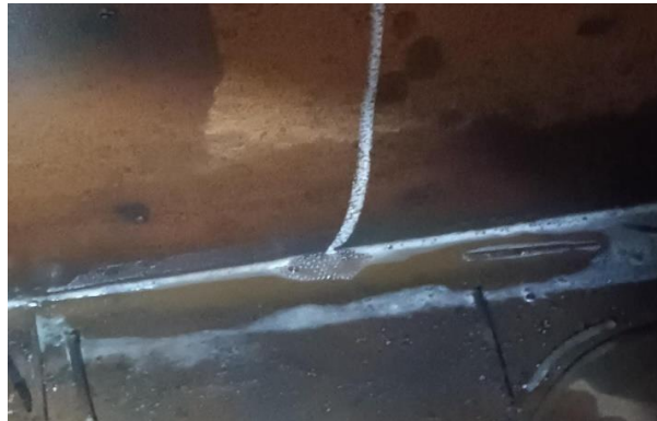
Gambar 3.15 Area yang bocor
