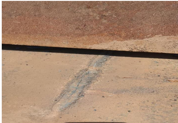
Gambar 2. 45 cacat pengelasan crack
