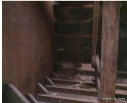
Gambar 1. 29 tangki yang belum di cleaning
