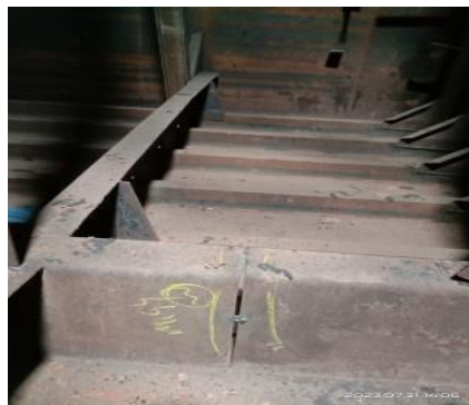
Gambar 1. 30 trans web yang mis welding
