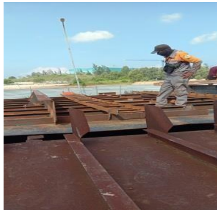
Gambar 1. 38 visual inspect pada trans bulkhead
