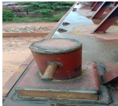
Gambar 1. 26 visual inspect pada bollar
