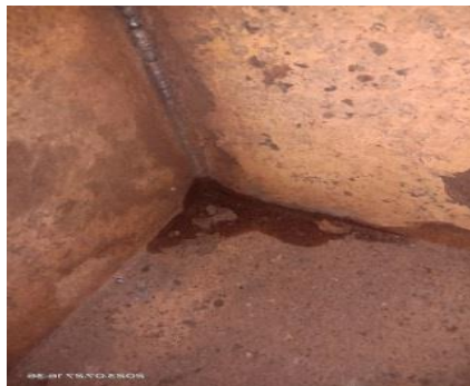
Gambar 1. 25 kebocoran pada vertical trans bulkhead
