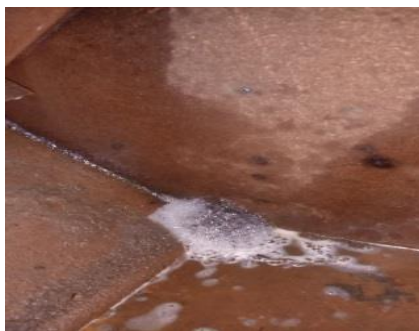
Gambar 1. 20 kebocoran dalam tangki
