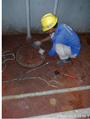
GAMBAR 2. 24 buka tutup manhole
