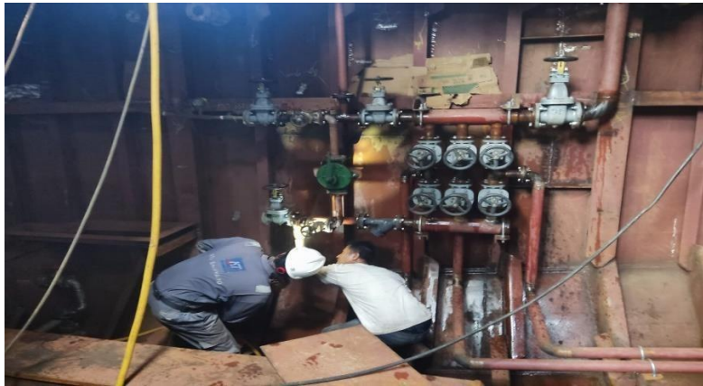
Gambar 2. 27 pengecekan kebocoran pipa
