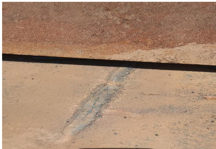
Gambar 2. 44 cacat pengelasan crack
