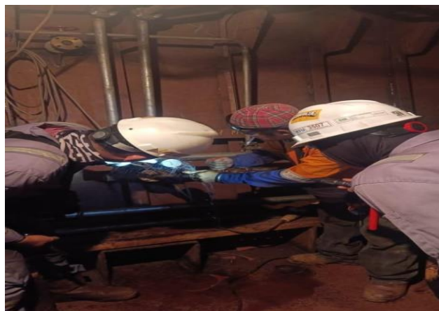
Gambar 2. 20 pengecekan kebocoran pada pipa
