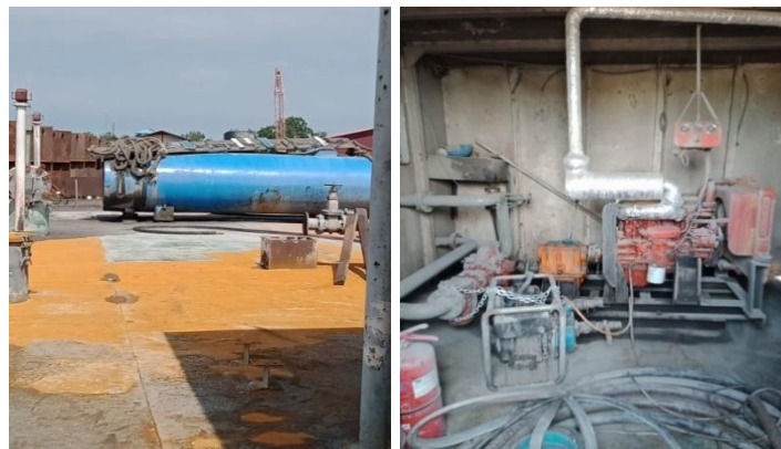
Gambar 2. 22 Tangki Tambahan Dan Ruang Mesin pompa
