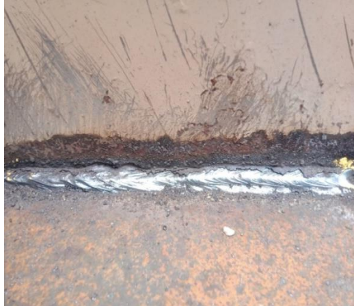
Gambar 2. 2 Cacat Las Undercut
