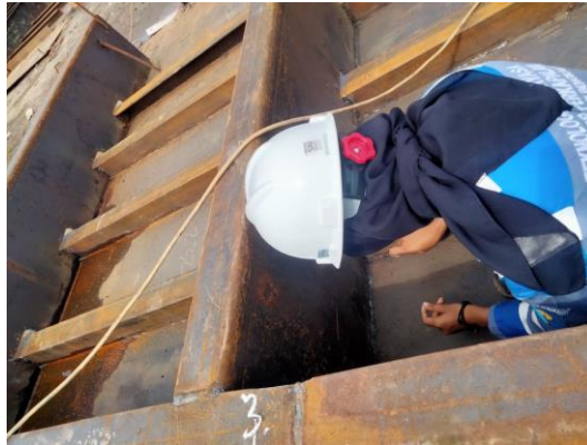
Gambar 2. 39 pengecekan cacat las bagian maindeck
