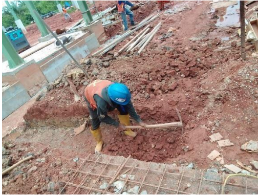
Penggalian gater area absorber
