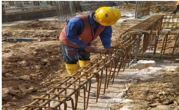
Gambar 3. 10 Pembesian Tie Beam (Sumber : Dokumentasi Pribadi, 2023 )
