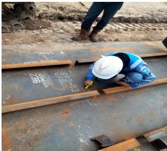
Gambar 2. 10 Cacat las welding
