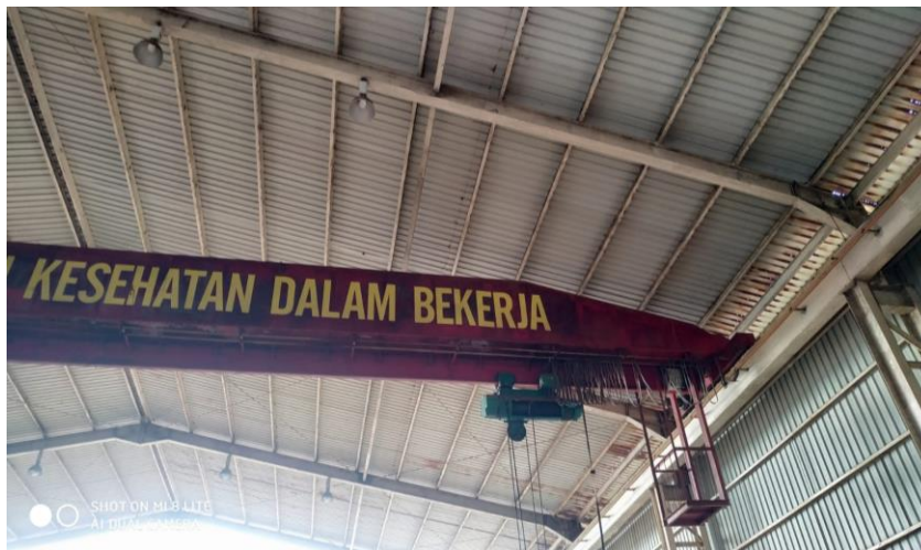
Gambar 1.16 Crane Overhead di PT. Lestari Osean Indonesia. Sumber : Dokumentasi penulis
