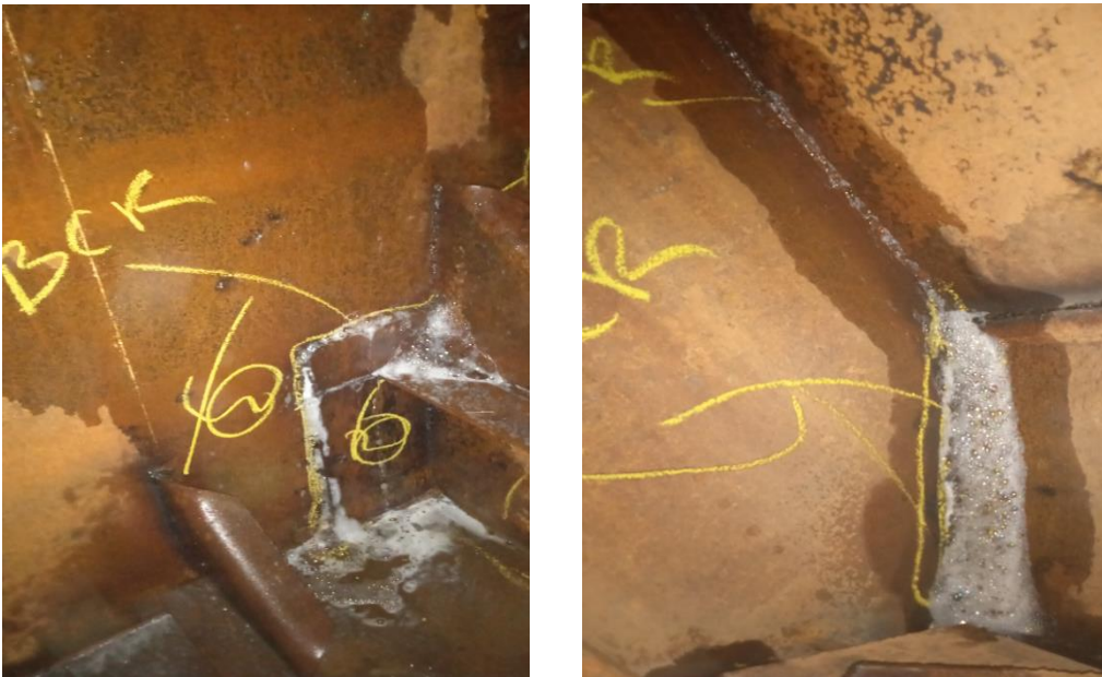
Gambar 6.22 Penandaan pada kebocoran
