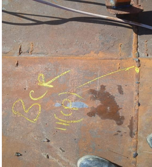
Gambar 2.16 Kebocoran pada tanki main deck
