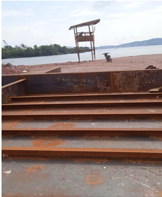
Gambar 3.30 Visual inspeks pada bagian T.bhd Hull 024 Sumber : Dokumentasi penulis
