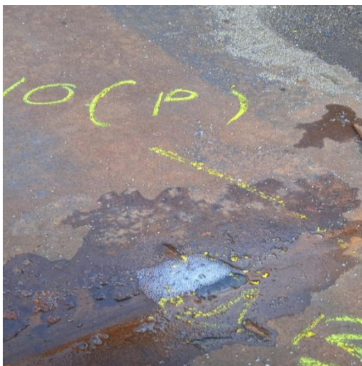
Gambar 2.7 Kebocoran pada main deck
