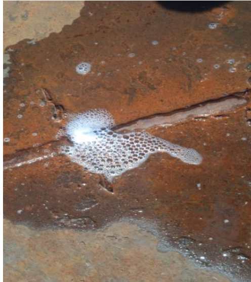
Gambar 2.8 Kebocoran pada main deck
