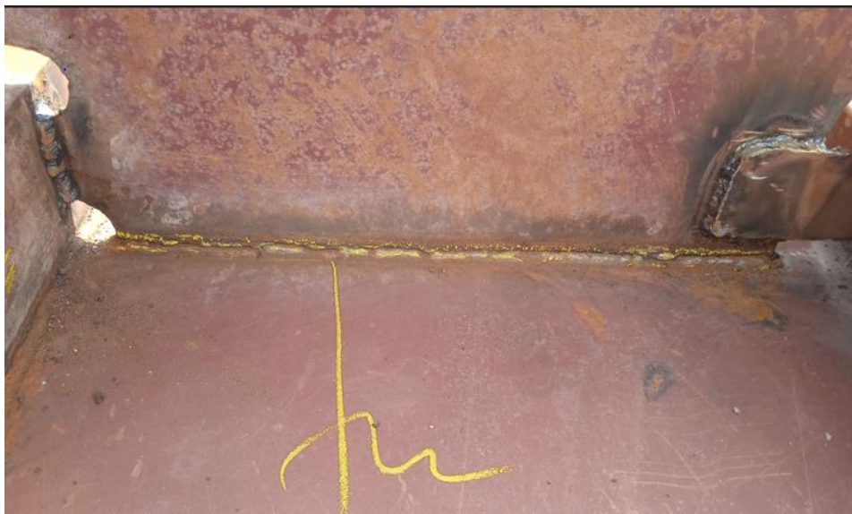
Gambar 4.19 Visual inspeks pada bagian Bottom
