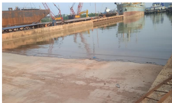
Gambar 1.6 Slipway PT. Lestari Osean Indonesia. Sumber : Dokumentasi penulis
