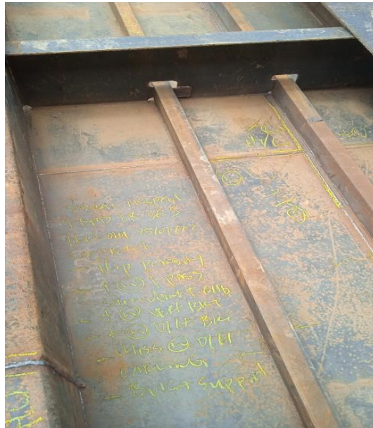
Gambar 2.26 Visual inspeksi pada tranbulkhead
