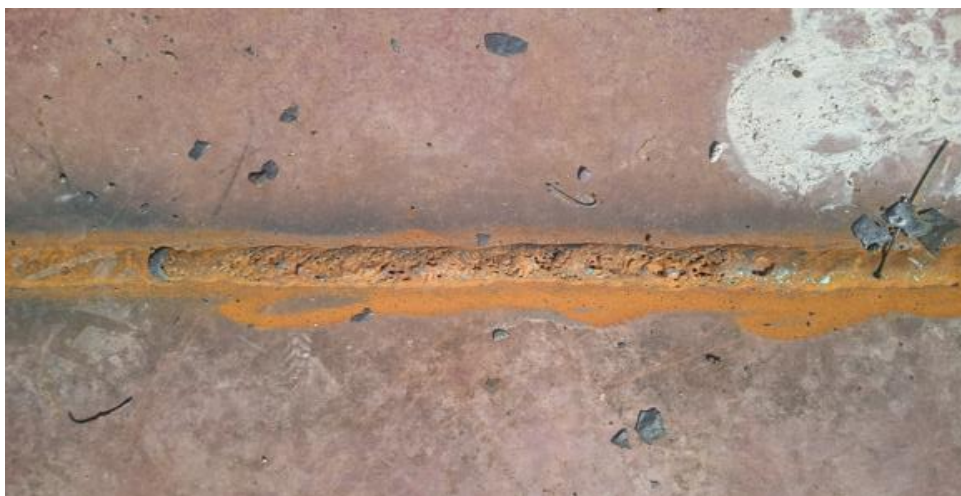
Gambar 4.20 Visual inspeks pada bagian Bottom
