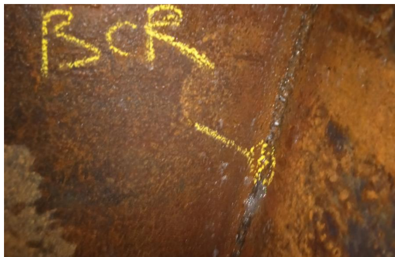
Gambar 2.15 Kebocoran pada tanki
