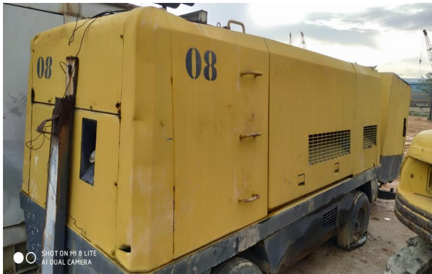
Gambar 1.18 Compressor Genset di PT. Lestari Osean Indonesia. Sumber : Dokumentasi penulis
