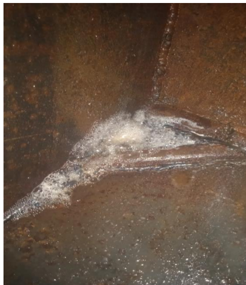
Gambar 2.17 Kebocoran pada tanki
