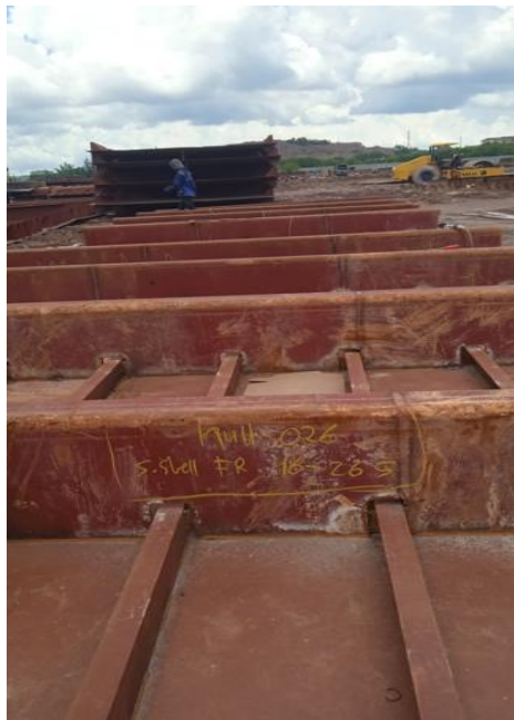
Gambar 4.17 Visual inspeks side shell
