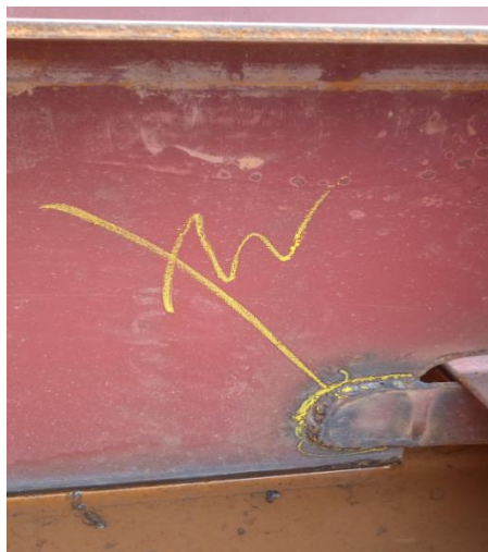
Gambar 3.33 Weldingan bagian collar yang kurang baik
