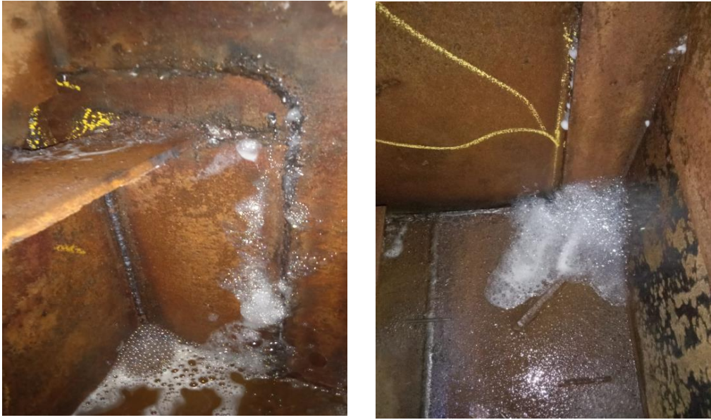
Gambar 6.21 Kebocoran pada Water Collar
