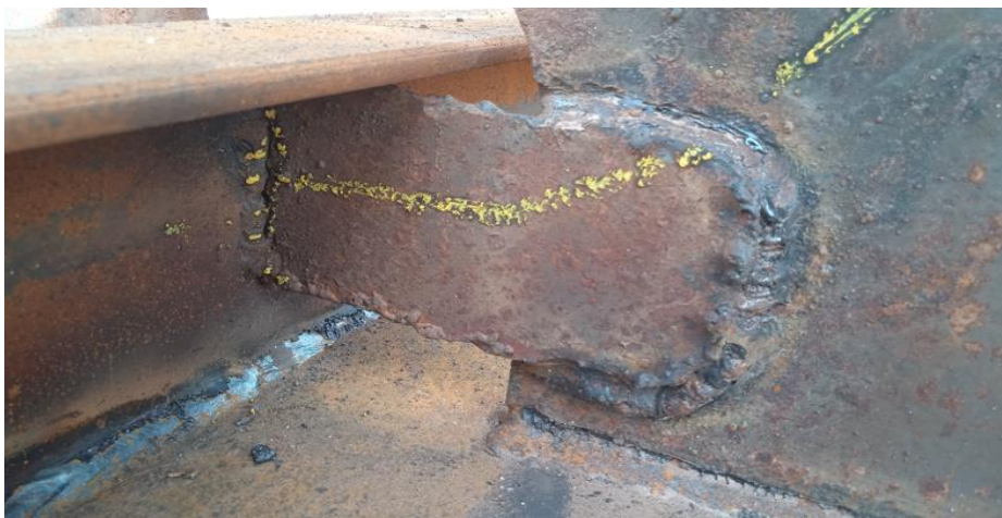
Gambar 4.24 Crack pada bagian Collar
