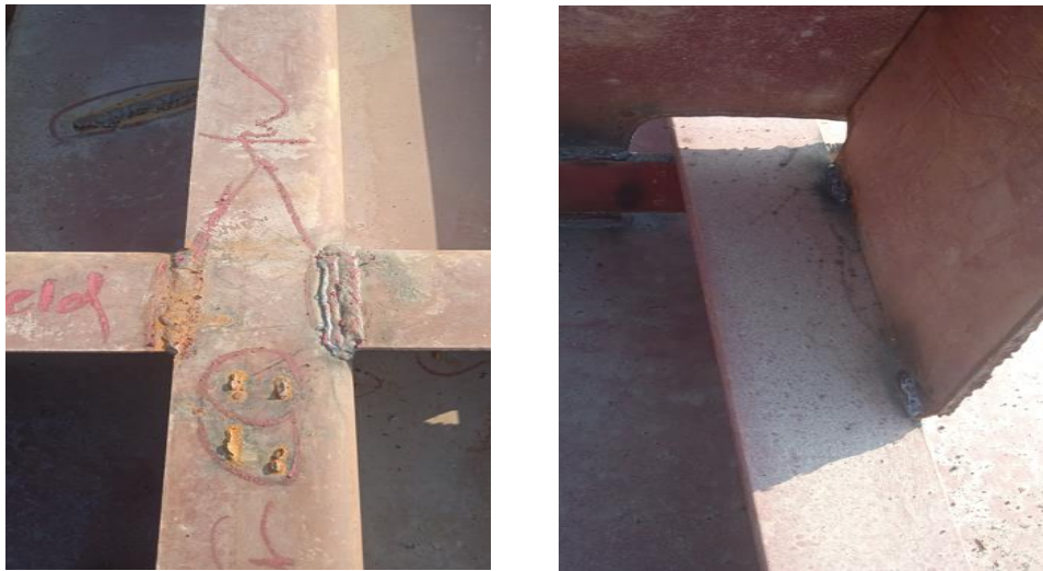
Gambar 4.7 Visual inspeks pada bagian Bottom 026
