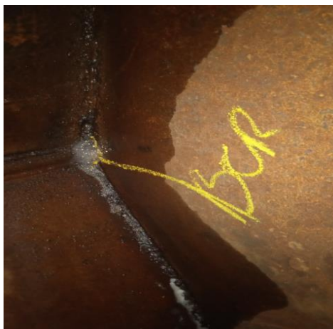
Gambar 2.13 Kebocoran pada tanki
