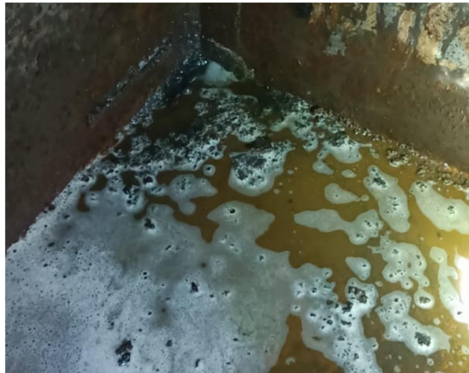
Gambar 3.19 Lokasi kebocoran area bottom
