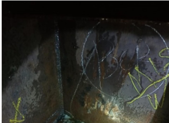
Gambar 3.20 Penandaan lokasi kebocoran.
