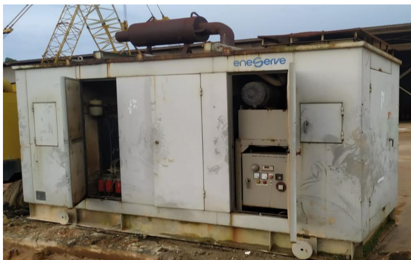
Gambar 1.7 Kelistrikan PT. Lestari Osean Indonesia Sumber : Dokumentasi penulis
