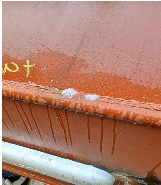
Gambar 2.13 Gambar salah satu titik kebocoran pada side shale
