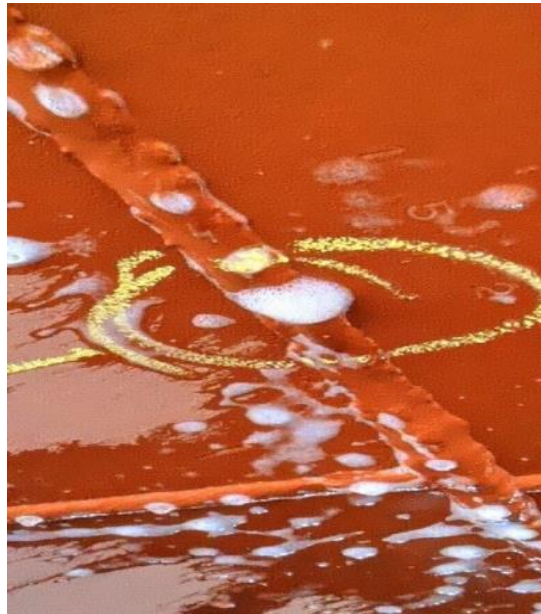
Gambar 2.18 Gambar titik kebocoran pada bagian bottom
