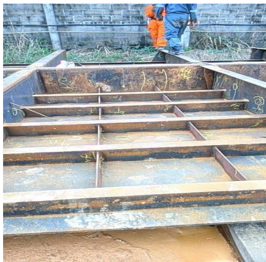
Gambar 2.6 Gambar visual inspek pada main deck
