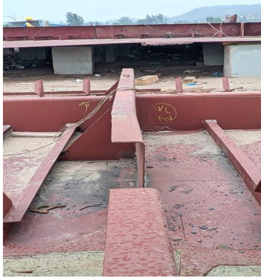
Gambar 2.65 Gambar pada bagian web girder yang tidak lurus
