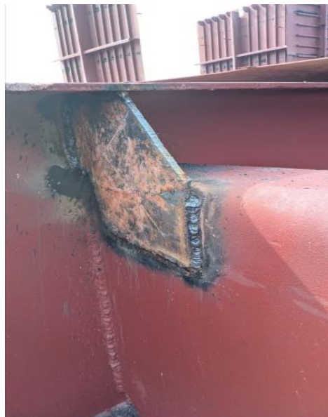
Gambar 2.80 Gambar fit up yang harus di repara Sumber : Dokumentasi Penulis
