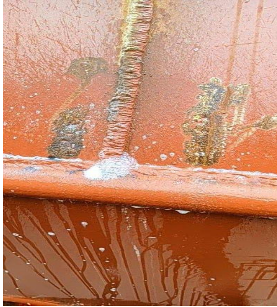
Gambar 2.12 Gambar titik kebocoran pada bagian side shale
