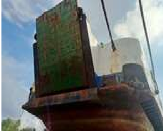
Gambar 2.117 Penurunan Ramp Door
