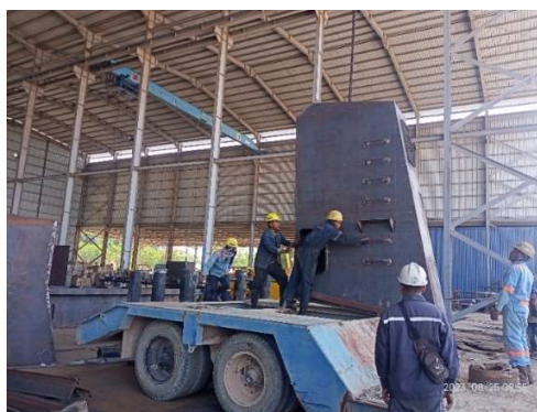
Gambar 2.42 Control Pemindahan Funell T.036 Louis Dolphin
