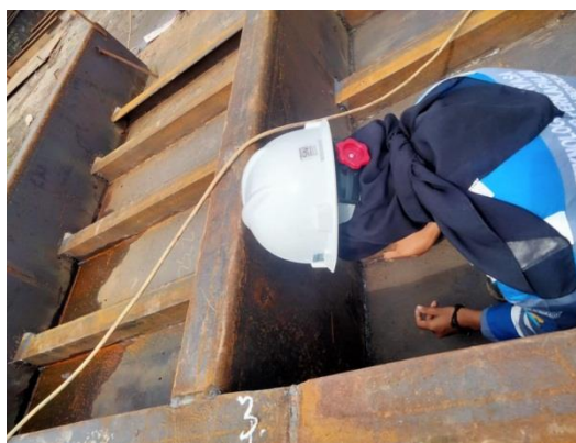
Gambar 2 55 pengecekan cacat las bagian maindeck
