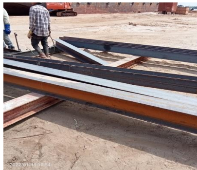
Gambar 2 49 Area yang akan di replating TB. Nelly 19
