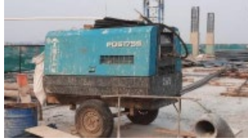
Gambar 3. 29 Air compressor Sumber : Dokumentasi Lapangan 2023
