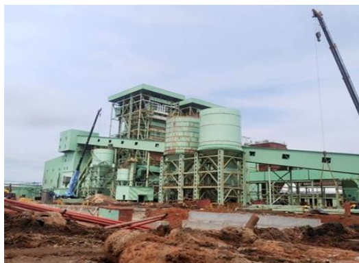
Gambar 2.1 Power Plant Sari Dumai Oleo (SDS2) Sumber : Dokumentasi lapangan, 2023
