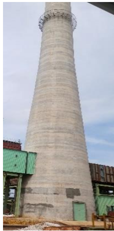
Gambar 2.9 Chimney (Sumber: Dokumentasi Lapangan 2023)
