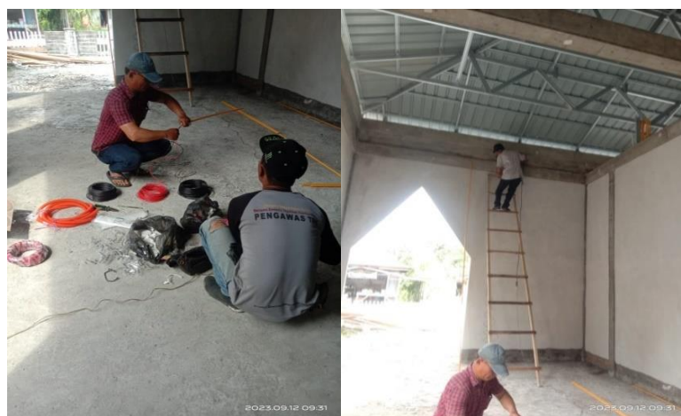
Gambar 3.42 Instalasi Listrik Proyek Baznas Sumber : Dokumentasi pribadi di lokasi proyek 2023
