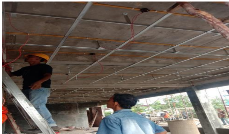
Gambar 3.44 Instalasi Listrik Proyek Workshop Sumber : Dokumentasi pribadi di lokasi proyek 2023
