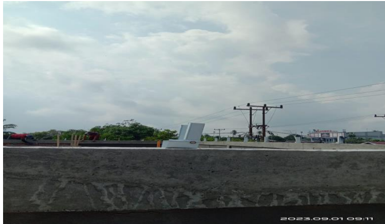
Gambar 3.25 Pemasangan Bracket Pengunci Kuda-kuda Proyek Baznas Sumber : Dokumentasi pribadi di lokasi proyek 2023
