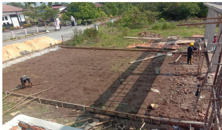
Gambar 3.62 Cerucuk dan Bekisting Jalan Bangunan Proyek Workshop Sumber : Dokumentasi pribadi di lokasi proyek 2023
