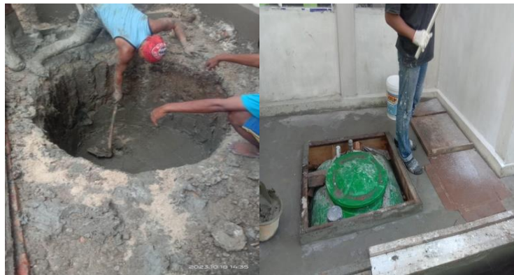
Gambar 3.60 Sumur Resapan Septictank Proyek Baznas Sumber : Dokumentasi pribadi di lokasi proyek 2023
