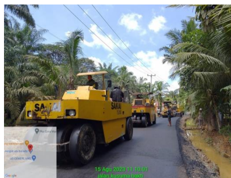
Gambar 4.7:Pekerjaan Pemadatan Akhir Aspal AC-WC Menggunakan Pneumatic Tire Roller Sumber : Dokumentasi lapangan, 2020
