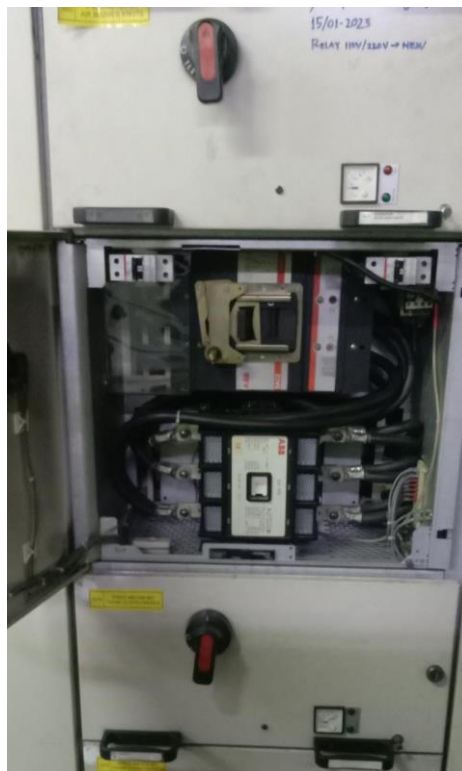
Gambar 3. 18 motor control center (Sumber : Dokumentasi PT. Indah Kiat pulp & paper Tbk Perawang, 2023)
