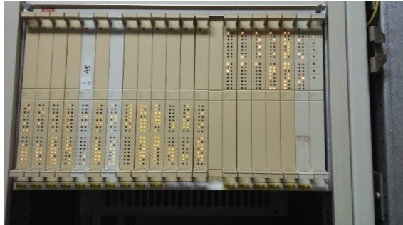
Gambar 3. 7 System I/O S100 (Sumber : Dokumentasi PT. Indah Kiat pulp & paper Tbk Perawang, 2023)
