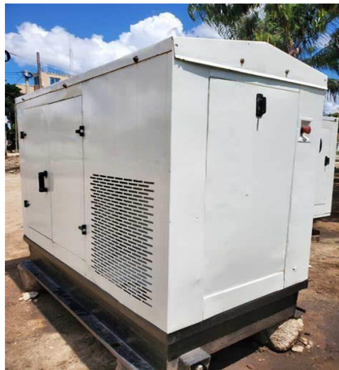
Gambar 4.24 Mesin Genset ( Sumber : Dokumentasi Lapangan )
