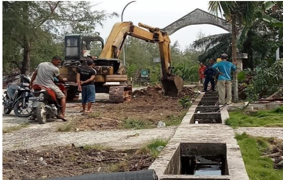
Gambar 3. 6 pembersihan dan pemotongan kayu di bahu jalan menggunakan alat excavator Sumber : Dokumentasi Lapangan, 2023
