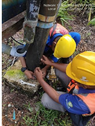
Gambar 2.32 Perawatan PHB TR (Sumber: Dokumentasi)
