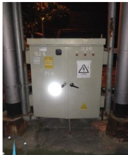
Gambar 3.9 Panel PHBTR (Sumber: Dokumentasi)
