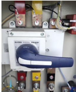
Gambar 3.10 Saklar utama (Sumber: Dokumentasi)
