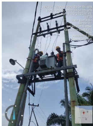
Gambar 2.37 Perawatan PHB TR (Sumber: Dokumentasi)
