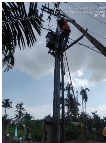
Gambar 2.33 Perawatan PHB TR (Sumber: Dokumentasi)
