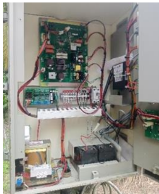
Gambar 2.16. Pengecekan baterai dan modem wifi LBS ( Load Break Switch ) (Sumber: PT. Adra Gemilang)
