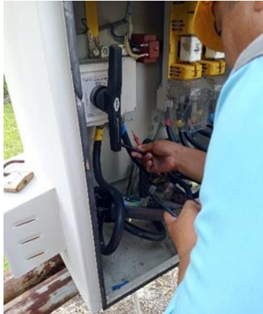
Gambar 2.4. Pengukuran beban trafo (Sumber: PT. Adra Gemilang)
