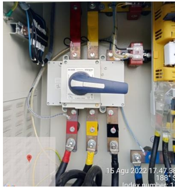
Gambar 2.46. Pemadaman trafo ditribusi (Sumber: PT. Adra Gemilang)
