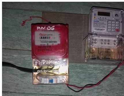
Gambar 2.51. Penggantian Kwh dummy (Sumber: PT. Adra Gemilang)
