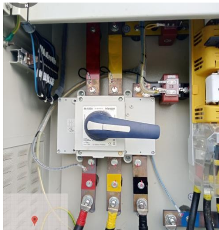
Gambar 2.27. Pemadaman trafo distribusi (Sumber: PT. Adra Gemilang)
