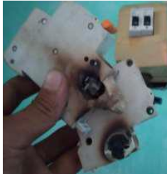
Gambar 2.15. Mcb rusak (Sumber: PT. Adra Gemilang)
