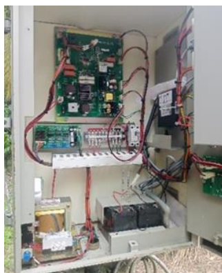
Gambar 2.26. Pengecekan baterai dan modem wifi LBS ( Load Break Switch ) (Sumber: PT. Adra Gemilang)
