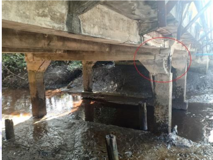
Gambar 1.2 Kerusakan Pada Jembatan (Sumber: Dokumentasi lapangan, 2020)
