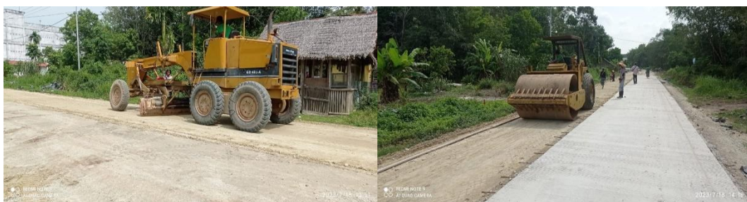
Gambar 3.2 Pemotongan dan Pematatan menggunakan Motor Grader dan Vibro Roller Sumber: Dokumentasi Lapangan, 2023
