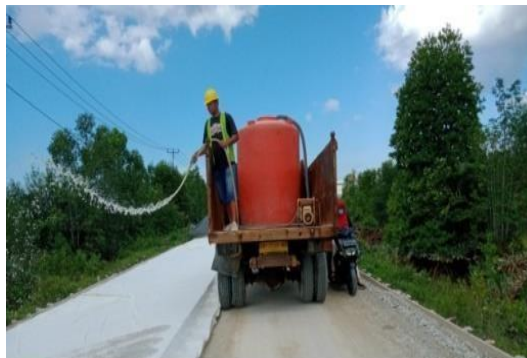
Gambar 3.29 Water Tank Sumber: Dokumentasi Lapangan, 2023
