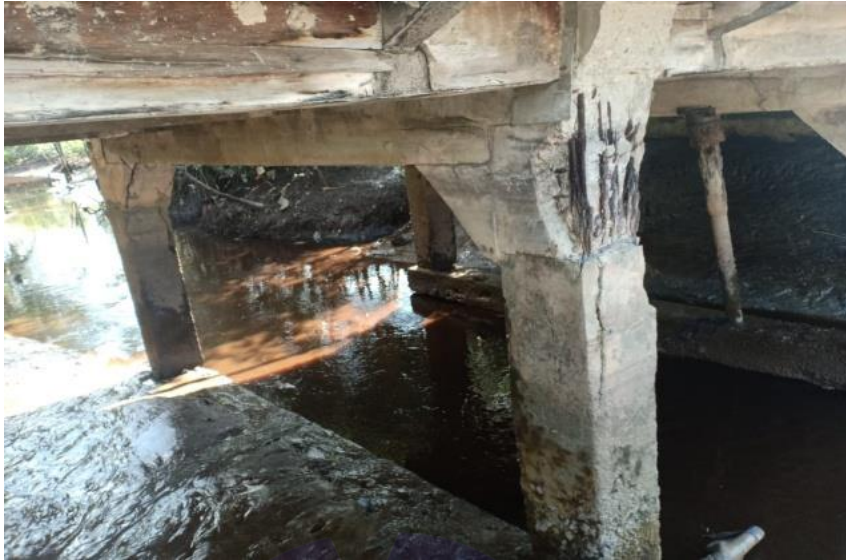
Gambar 1.2 Kerusakan pada jembatan sungai Bengkalis.
