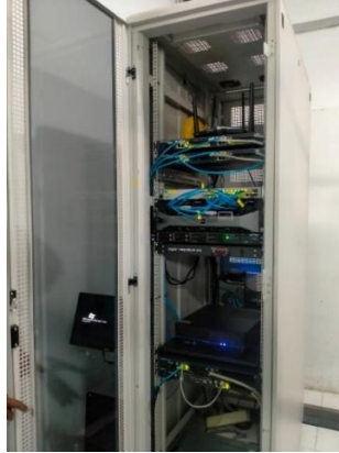
Gambar 3. 2 Pengecekan server (Sumber: Dokumentasi pribadi, 2024)
