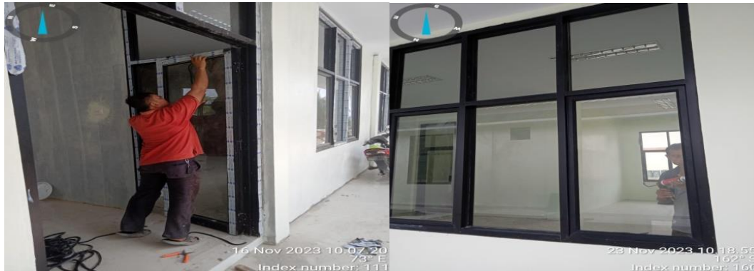
Gambar 3.27 Pemasangan kaca jendela, pintu, dan ventilasi utama dan aula Sumber; Dokumentasi Pribadi dilokasi proyek
