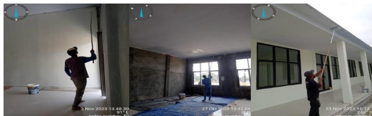
Gambar 3.34 Pengecatan dinding dan plafond utama dan aula Sumber; Dokumentasi Pribadi dilokasi proyek
