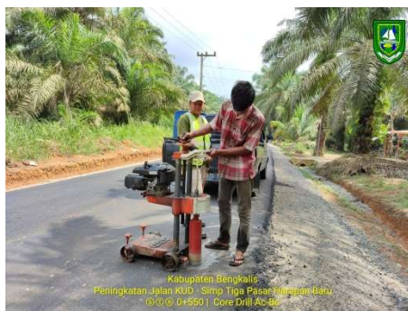
Gambar 3.1.24. Core Drill Test Laston Lapis Aus (AC-WC) (Sumber: Dokumentasi Lapangan Kerja Praktek 2023)
