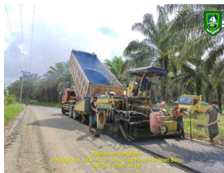
Gambar 3.2.17. Proses Masuk Laston Lapis Aus (AC-BC) ke dalam Asphalt Finisher (Sumber: Dokumentasi Lapangan Kerja Praktek 2023)
