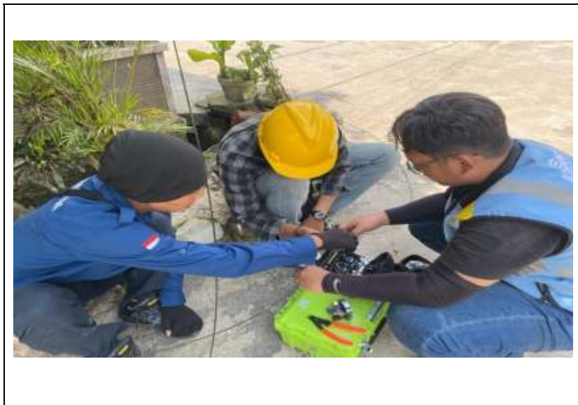
Gambar 3. 9 Penyambungan Fiber Optic menggunakan Splicer
