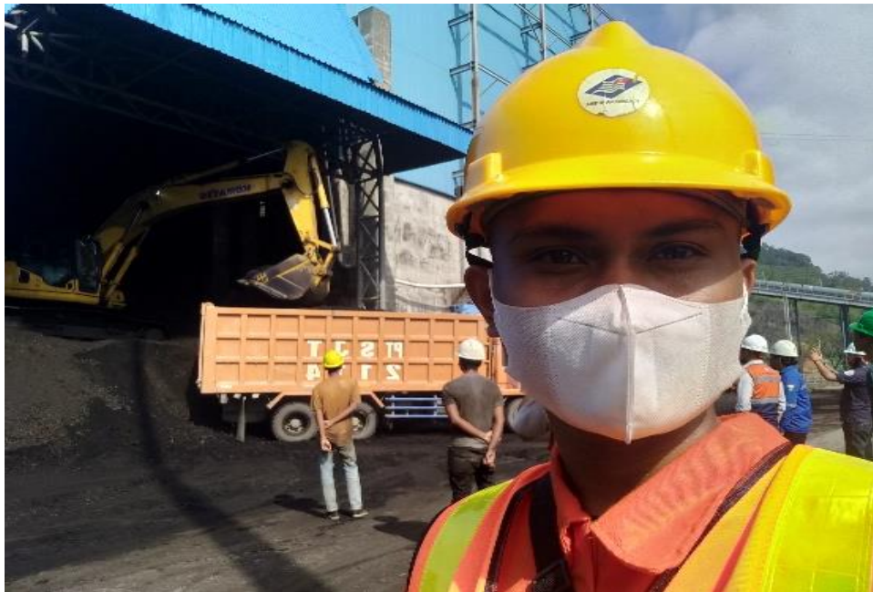
Gambar 2 Muat Batu Bara di PLTU Teluk Sirih Sumber : Dokumentasi Pribadi
