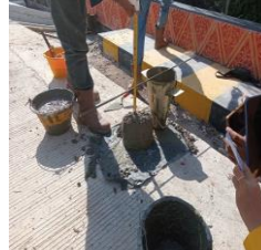
Proses pengukuran tinggi campuran beton dengan tinggi kerucut menggunakan tongkat pemadat dan meteran
