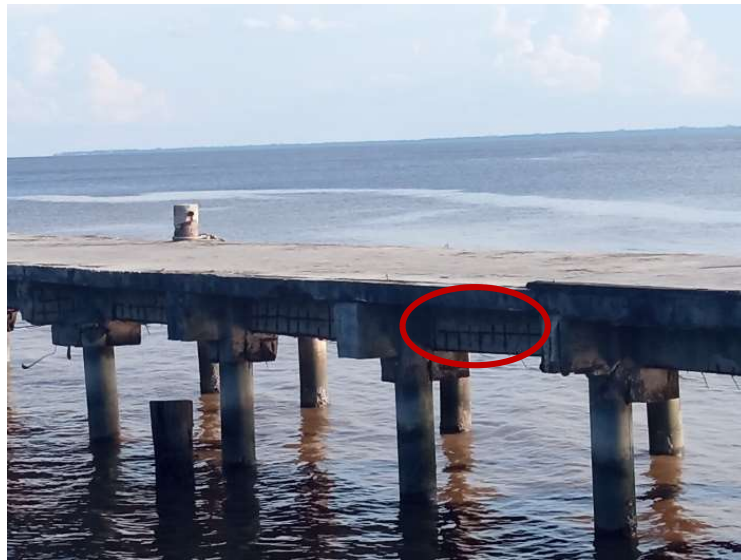
Gambar 1. 1 Penampakan Balok Beton Bertulang Akibat Korosi di daerah Pesisir Sumber : Dokumentasi Mandiri 2023
