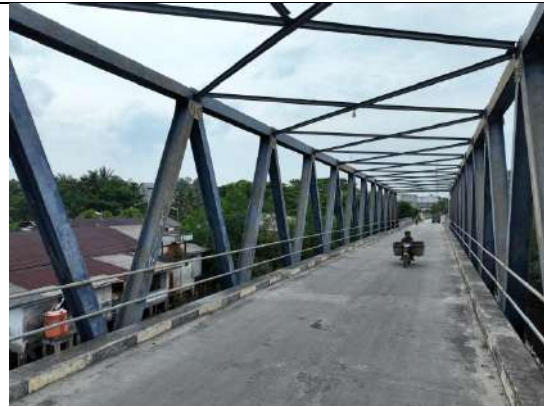
BESI RAILING PERLU DI CAT
