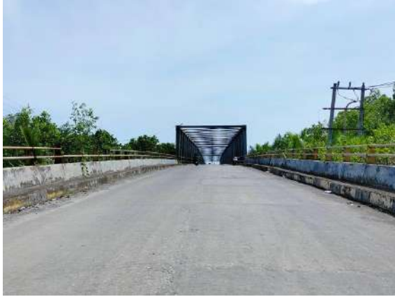
ARAH KELUAR JEMBATAN
