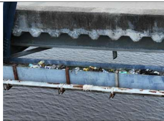
PENUMPUKAN SAMPAH PADA BALOK STRINGER
