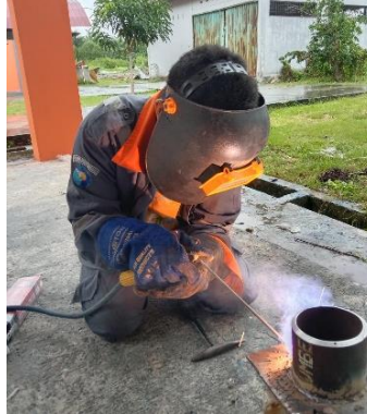
Gambar 4.56 Proses pengelasan 2F defect (cacat las) Sumber: Penulis
