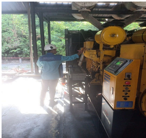
Gambar 2. 22 Kegiatan monitoring KWH setiap jamnya (Sumber: PT. Megapower Makmur Tbk. 2022)
