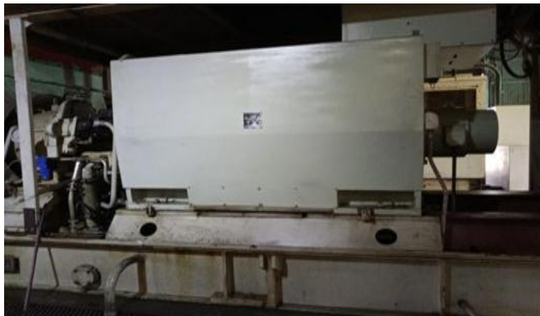
Gambar 3. 1 Generator (Sumber: Dokumentasi, 2023)
