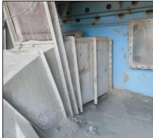
Gambar 4. 25 Outlet duct ( Sumber : Dokumen pribadi)
