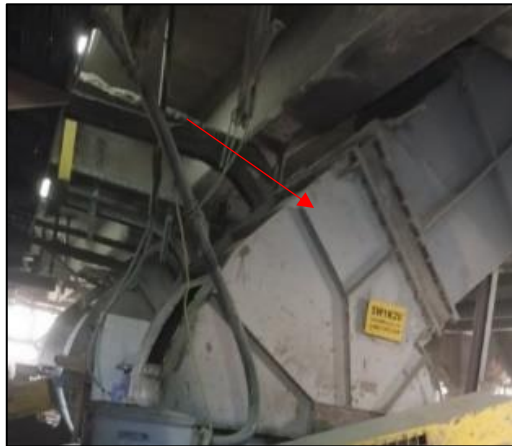
Gambar 4. 23 Duct ( Sumber : Dokumen pribadi)
