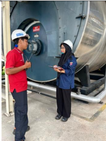
Mempelajari tentang Boiler Gas
