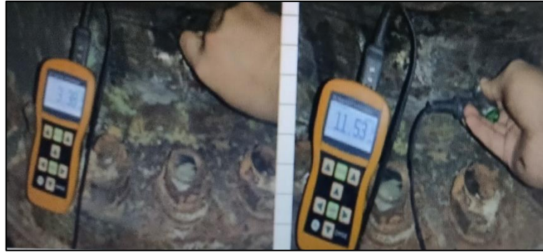
Gambar : 4.23 Hasil pengukuran ketebalan pipa
